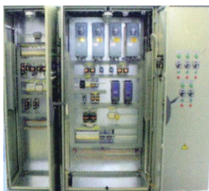
Внешний вид шкафов РШУ1, ШПЧ и РШУ2 щита ЩУ-ЧЭ (пример)
